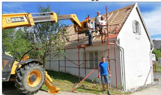
Im Vordergrund der Leiter unseres Bauhofes Josef „Seppi“ Haas, auf dem Dach Franz Scheucher, Markus Haas, Christian Krammer und Wolfgang Kranzelbinder. Emmerich Pfeiler, der auch mitgearbeitet hat, ist auf dem Foto nicht zu sehen; Foto: Heinz Kranzelbinder
