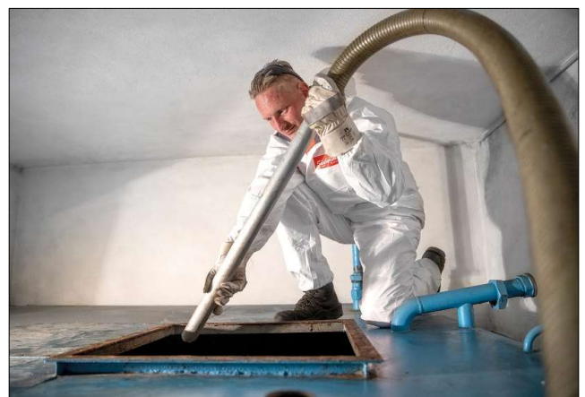
Eine Tankreinigung kann auch mit vollem Öltank durchgeführt werden.
